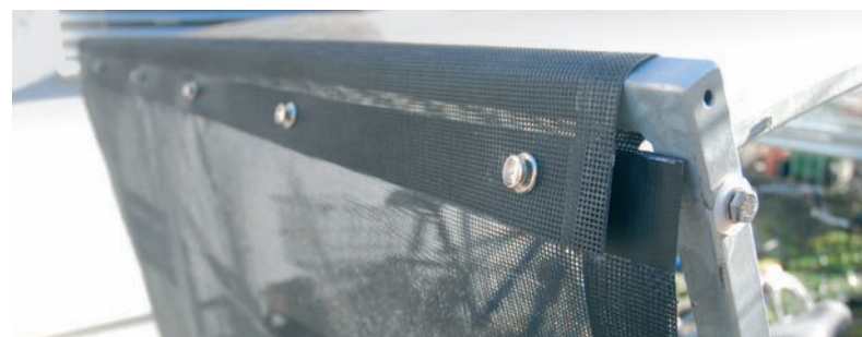
Detailansicht der Befestigung des Wetterschutzes aus Gittergewebe
